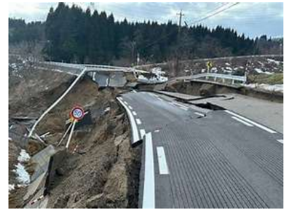
道路・ガス・水道設備の破壊
